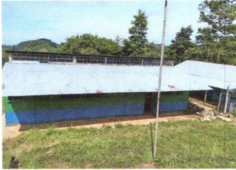
Foto1: El techo del modulo 1 se necesita cambair de lamina.
