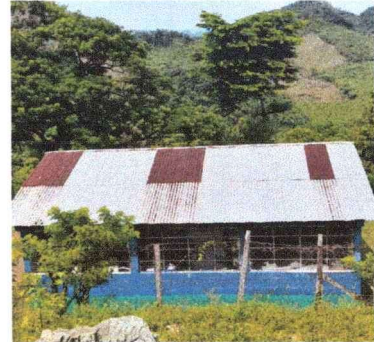
Foto2: El techo del modulo 2 del establecimiento requiere cambio de lamina.
