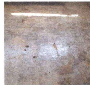
Foto 6: Se observa el piso en mal estado, se colocara piso ceramico del modulo 1.
